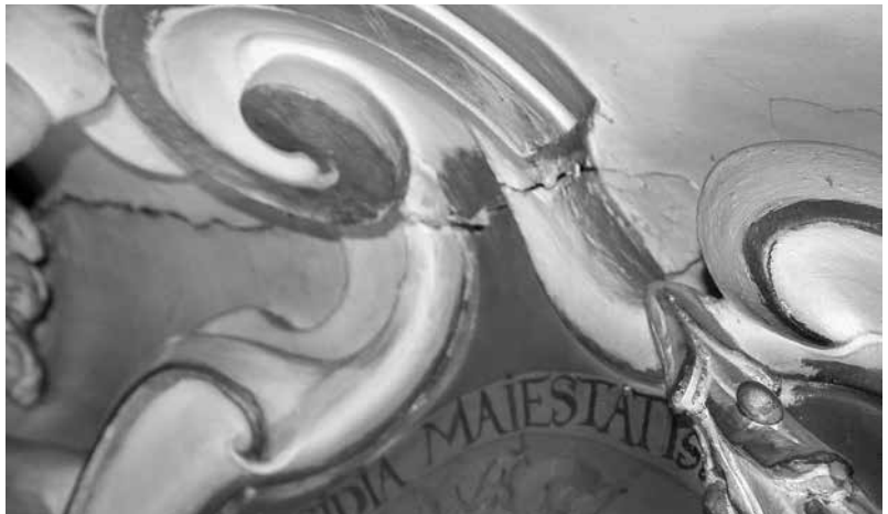
Tiefe Risse lösten Teile der Stuckdekoration von der Decke, Foto: UMJ/PS
