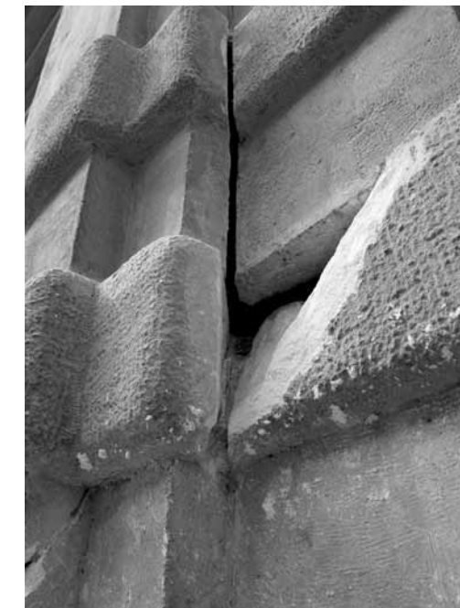
Fortschreitende Korrosion an den historischen Eisenarmierungen hinter den Sandsteinelementen führte zum Lösen einzelner Teile und zur Bildung breiter Fugen. Die rechtzeitige Restaurierung konnte ein weiteres Vorschreiten des Schadens durch eindringende Feuchtigkeit verhindern. Foto: UMJ/Schloss Eggenberg
