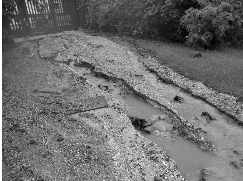
Zerstörungen eines Unwetters im Mai am Weg beim Baiertor, Foto: UMJ/P. Schuster
