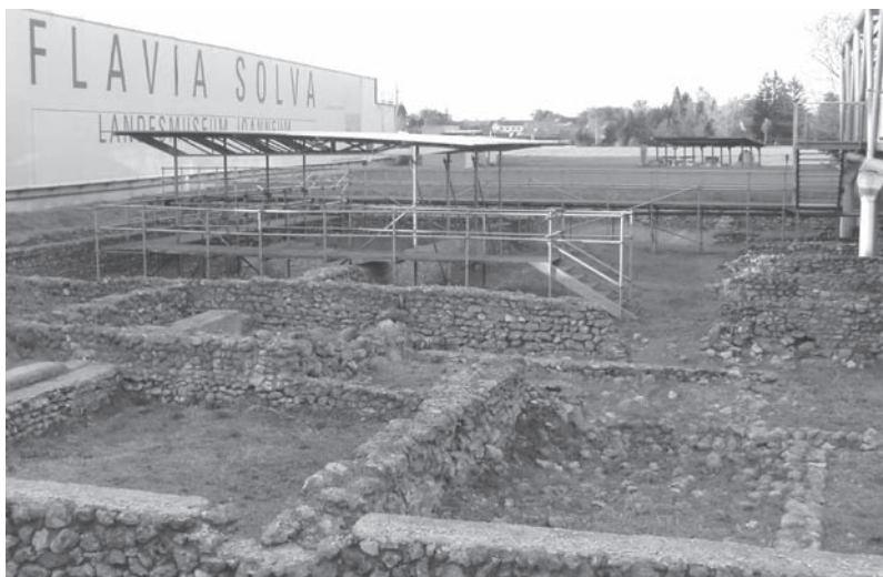
Blick auf die sanierungsbedürftigen römertzeitlichen Mauern der Insula XXII-Ost von Flavia Solva, Foto: UMJ
